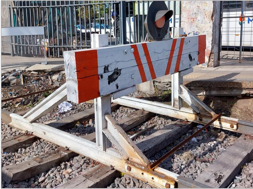
Figura 3. Marcas de impacto en el FDV de la vía 5. Fuente: JST, 2023
