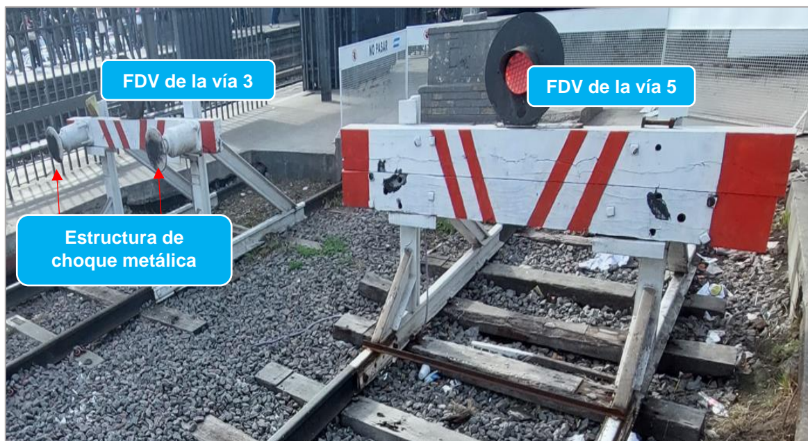
Figura 2. Estado de los FDV de la vía 3 (izquierda) y de la vía 5 (derecha) de la estación Merlo. Fuente: JST, 2023
