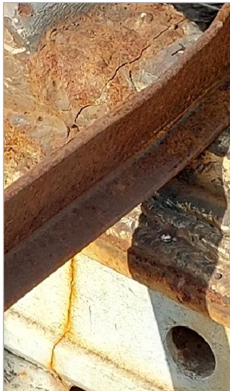
Figura 4. Fisuras en la estructura de soporte del FDV de la vía 5. Fuente: JST, 2023
