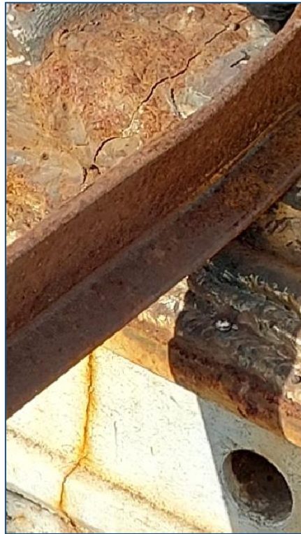
Figura 5. Fisuras en la estructura de soporte del FDV de la vía 5. Fuente: JST, 2023
