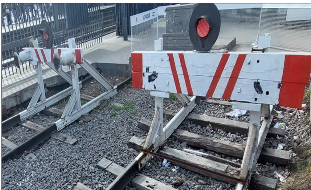
Figura 3. Estado de los FDV de la vía 3 (izquierda) y de la vía 5 (derecha) de la estación Merlo.
