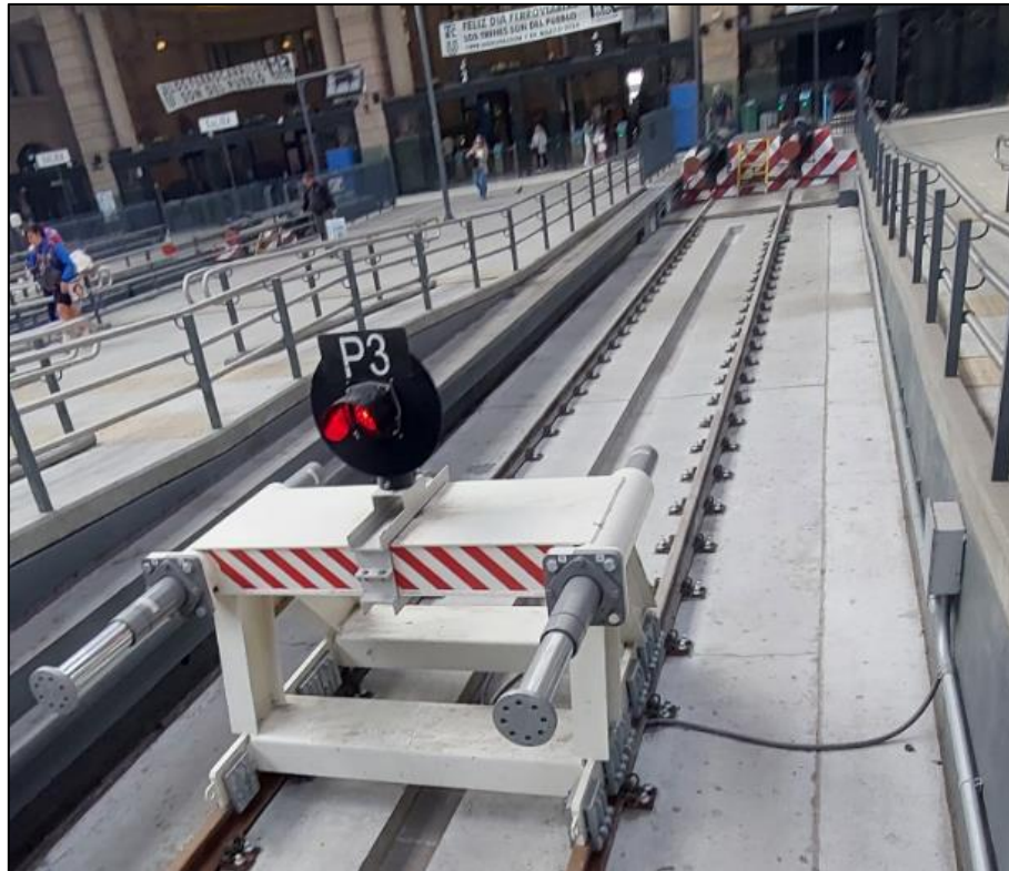
Figura 41. FDV de fricción e hidráulico en la vía 3, estación Retiro de la LM. Fuente: JST, 2024
