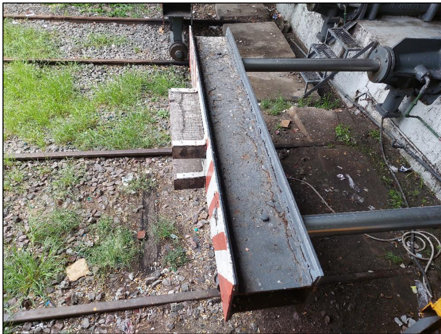
Figura 9. Viga del FDV con pérdida de material en la estación Once. Fuente: JST, 2024
