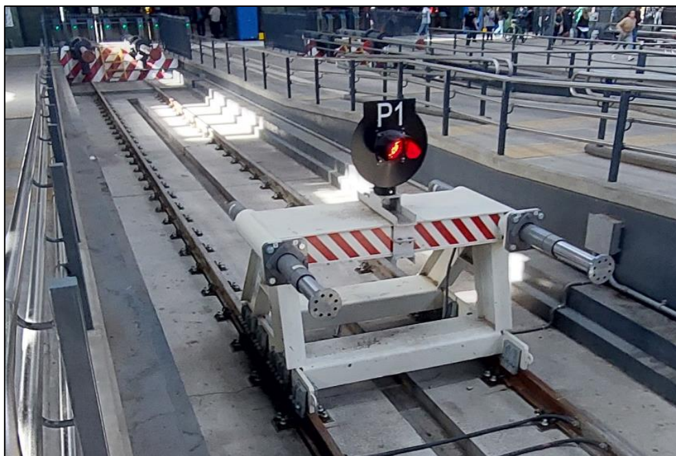
Figura 43. FDV de fricción e hidráulico en la vía 1, estación Retiro de la LM. Fuente: JST, 2024
