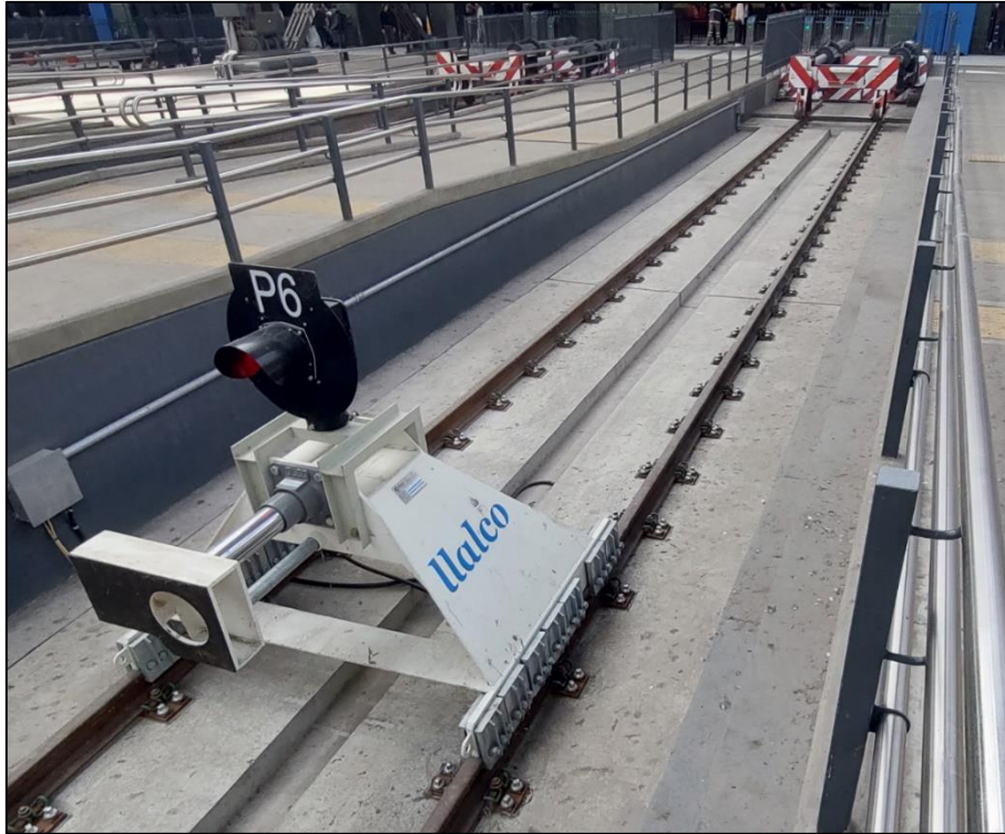
Figura 38. FDV de fricción e hidráulico en la vía 6, estación Retiro de la LM. Fuente: JST, 2024
