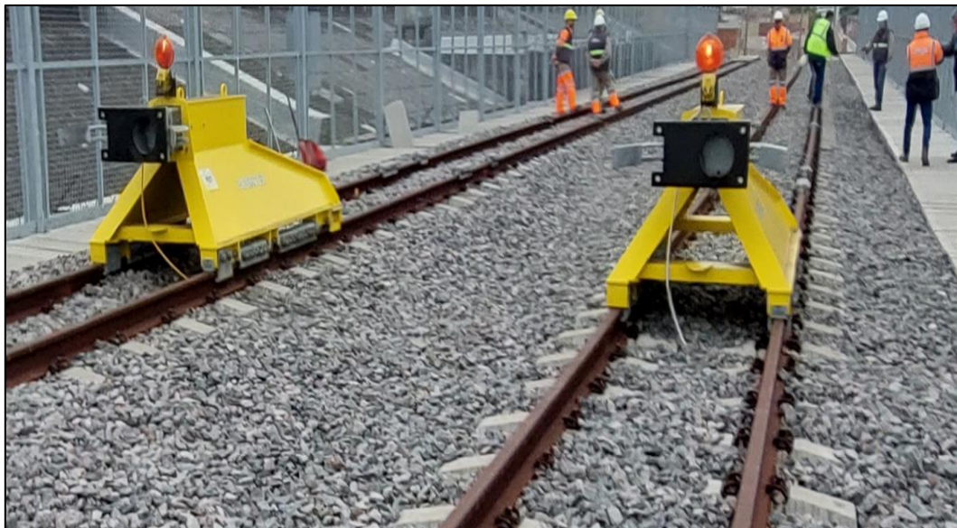
Figura 51. FDV en las vías de la estación cabecera Dr. Sáenz sobre el viaducto.
