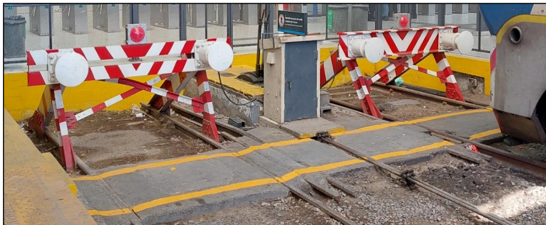
Figura 35. FDV de las vías 5 y 6 de la estación Retiro de la LSM. Fuente: JST, 2024
