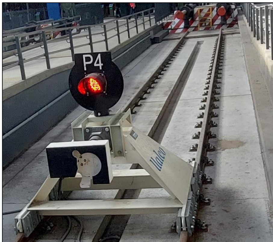
Figura 40. FDV de fricción e hidráulico en vía la 4, estación Retiro de la LM. Fuente: JST, 2024
