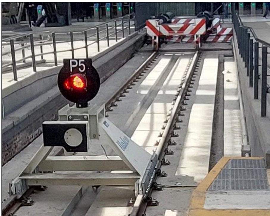
Figura 39. FDV de fricción e hidráulico en la vía 5, estación Retiro de la LM. Fuente: JST, 2024
