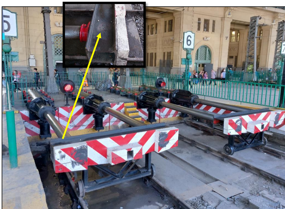
Figura 17. FDV de vía la 6 y FDV de la vía 5 con corrosión, estación Constitución.
