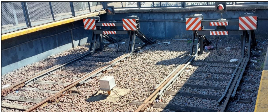
Figura 45. FDV en las vías de la estación Tigre, lado sur. Fuente: JST, 2024
