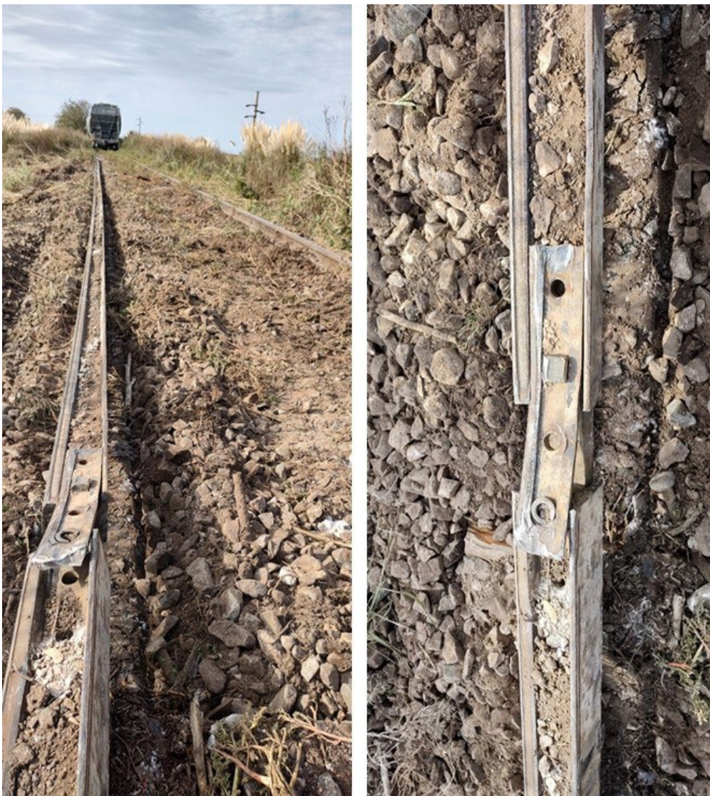
Figura 3. Daños en la superestructura de vía. Fuente: JST, 2023
