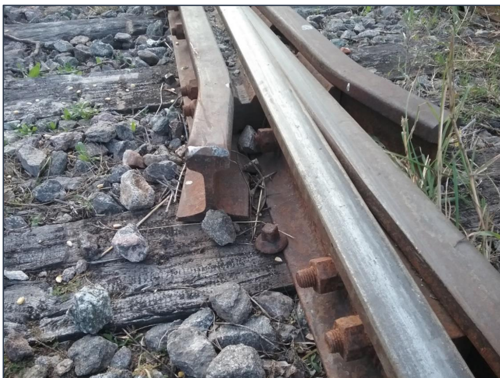
Figura 12. Marcas de impacto en el contrarriel del ADV previo al lugar del suceso. Fuente: JST, 2023
