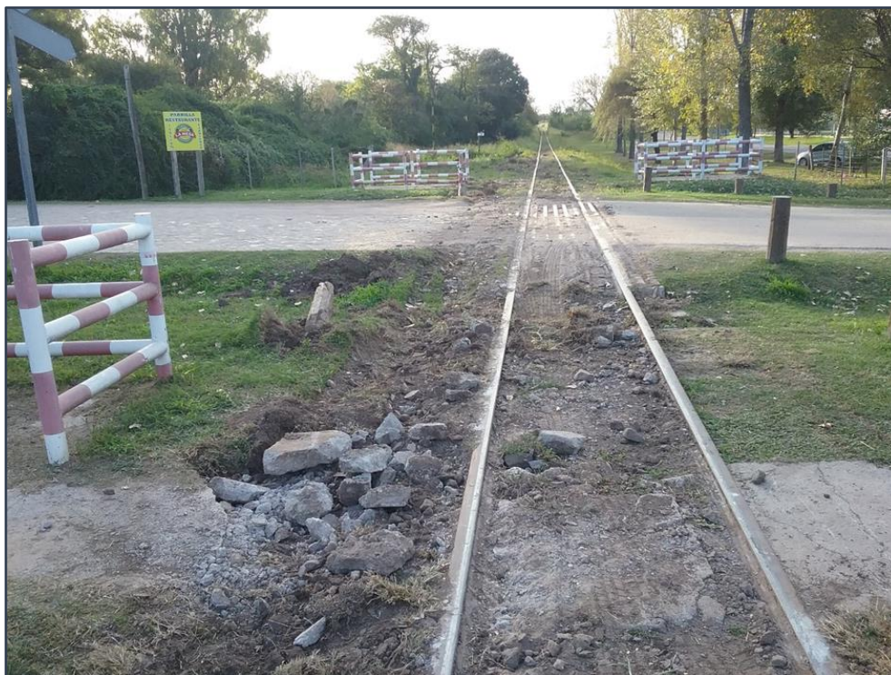
Figura 10. Vista del PAN en el sentido de circulación luego del retiro de los vagones.
