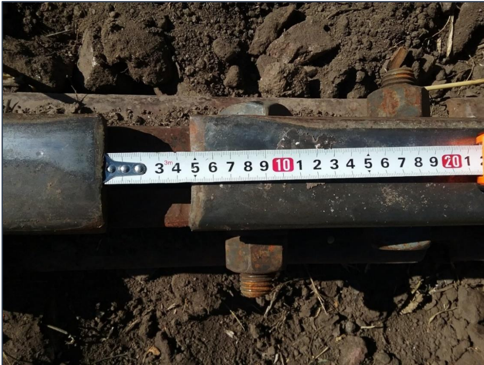
Figura 13. Medición de la junta eclisada a 7,3 km del lugar del suceso. Fuente: JST, 2023
