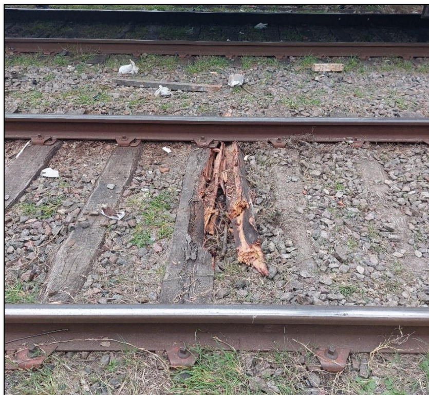
Figura 8. Daños en durmiente. Fuente: JST, 2023
