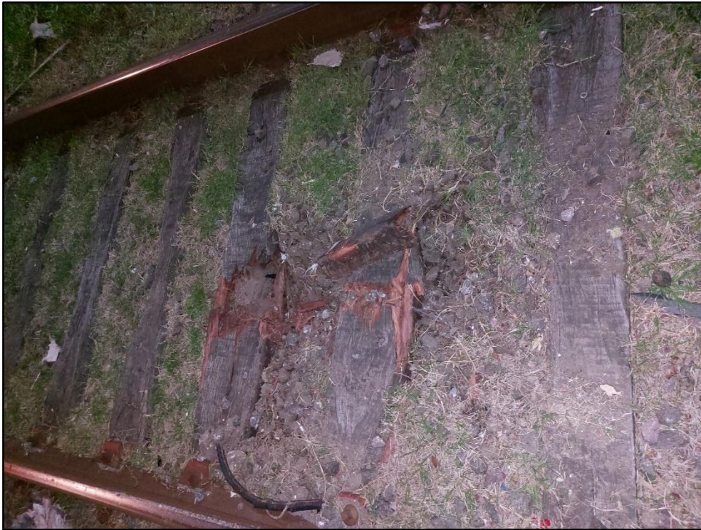
Figura 7. Durmientes dañados de la vía ascendente. Fuente: JST, 2023
