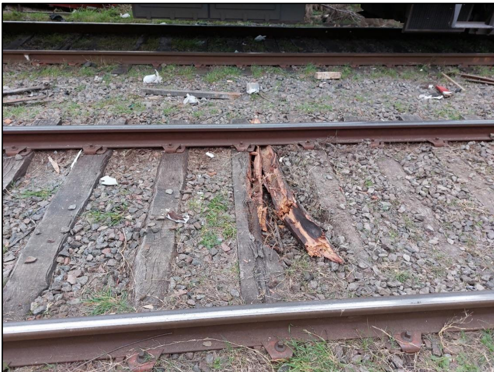
Figura 6. Durmiente dañado de la vía descendente. Fuente: JST, 2023
