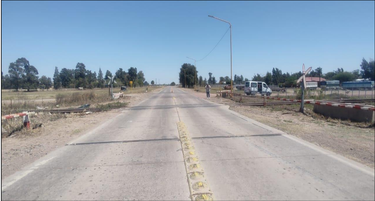
Figura 4. Línea de separación mimetizada con la calzada en cercanías del PAN de la RP 2.
