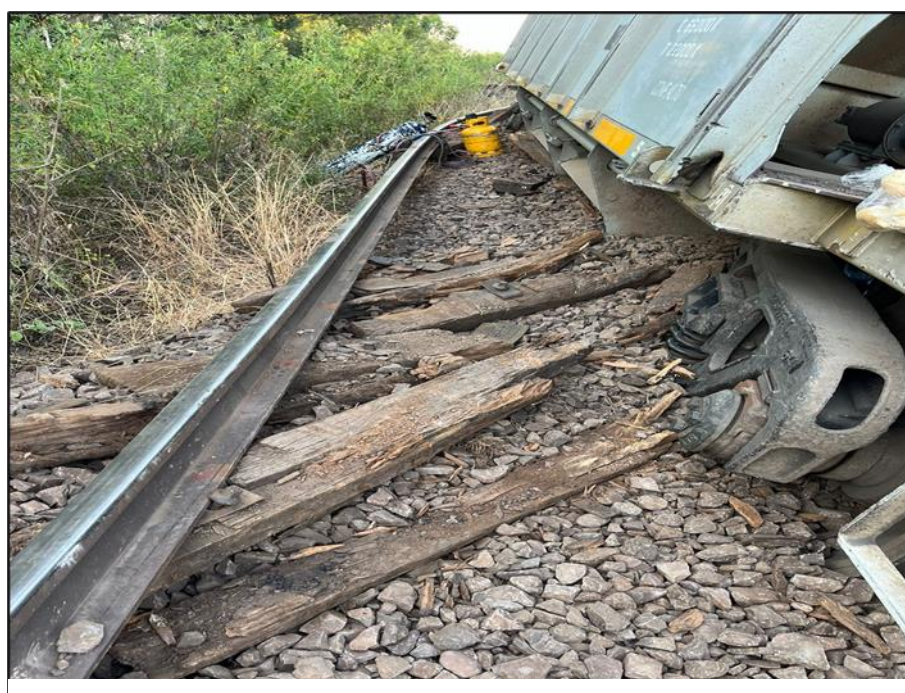
Figura 6. Durmientes dañados. Fuente: JST, 2024
