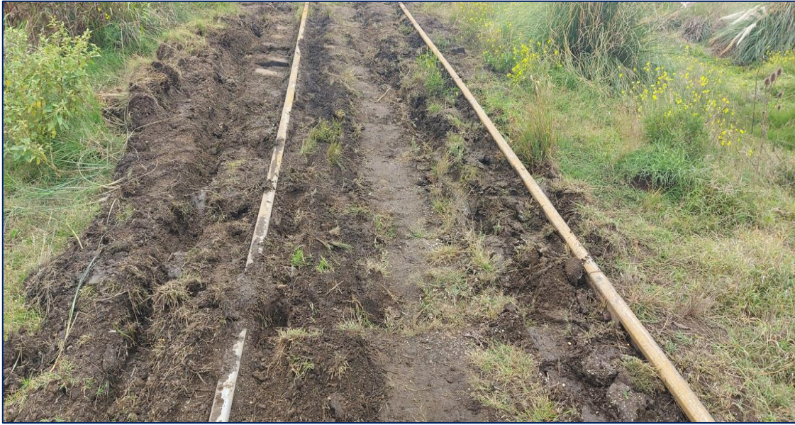
Figura 4. Marcas en la tierra, paralelas a las vías, indicativas de la trayectoria de los pares montados descarrilados. Fuente: JST, 2024
