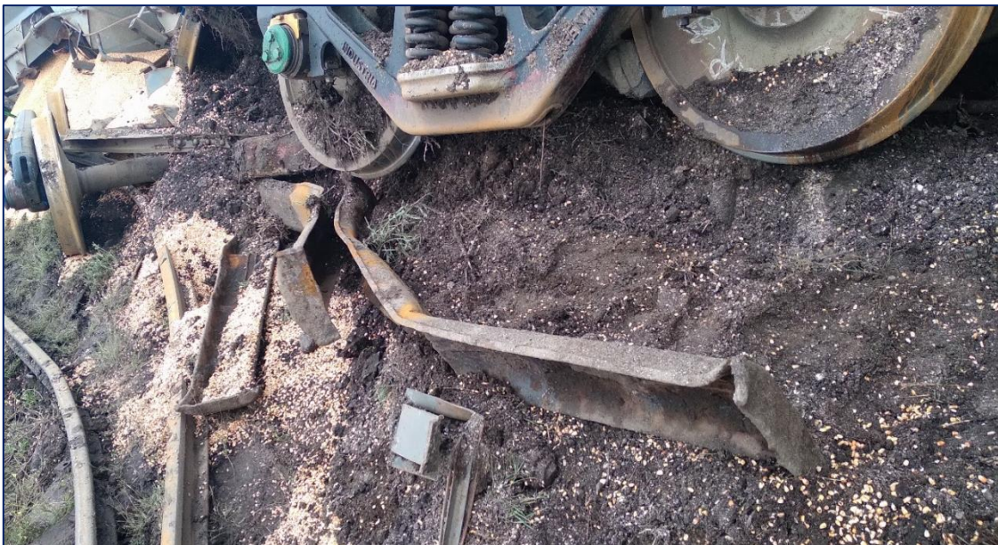
Figura 8. Estado de los durmientes, deformación y rotura de la enrielladura y pérdida de los parámetros geométricos del balasto. Fuente: JST, 2024
