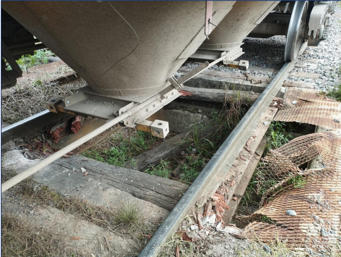
Figura 3. Daños ocasionados a las alcantarillas del tramo afectado. Fuente: JST, 2024
