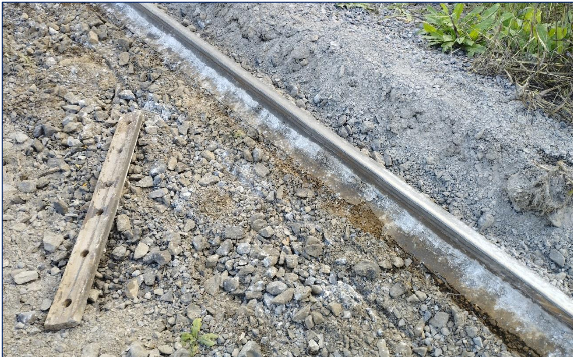
Figura 4. Daños en la superestructura de vía producto del suceso. Fuente: JST,2024
