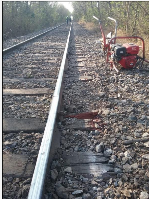
Figura 2. Marcas de pestaña entre los kilómetros 539 y 532. Fuente: JST, 2024
