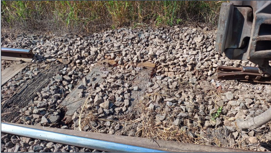
Figura 3. Vista de la parte trasera del corte del tren hallado durante el relevamiento respecto del sentido de la marcha. Fuente: JST, 2025
