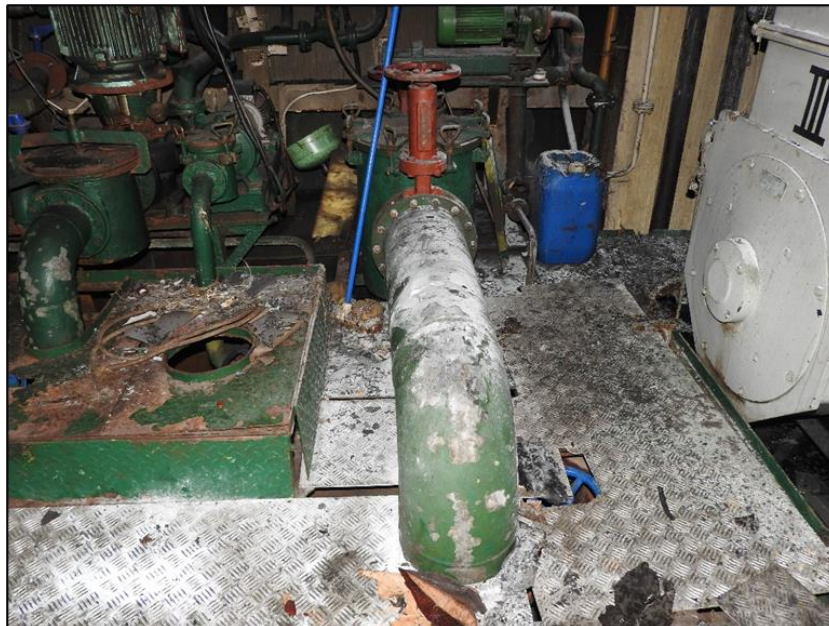
Figura 4. Sector a popa del motor auxiliar N.º 3
