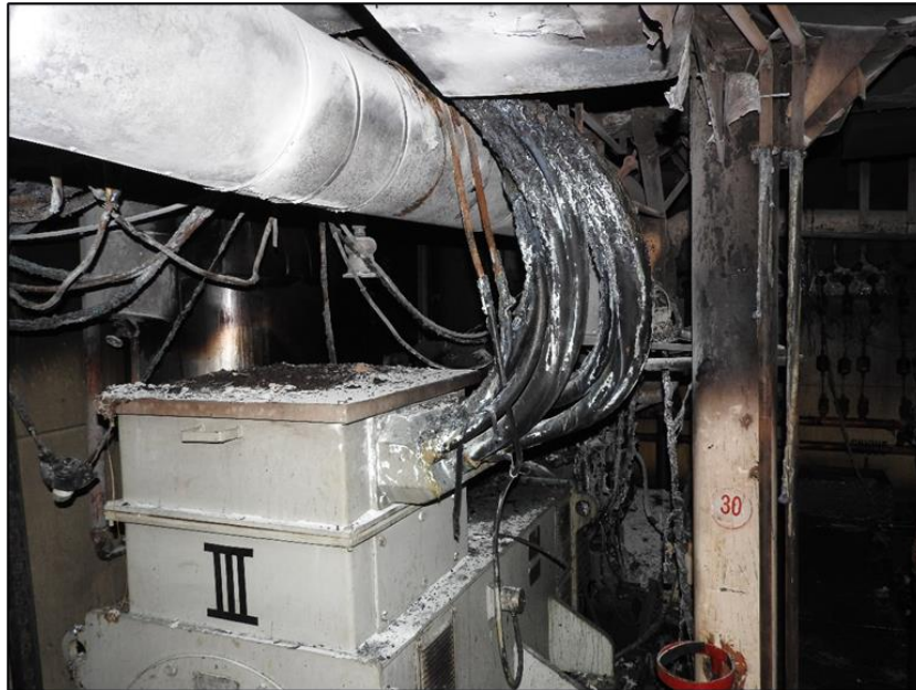
Figura 5. Cables de potencia y control. Ubicados al ingreso del alternador del motor auxiliar N.º 3 Fuente: Material documental.
