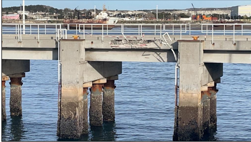
Figura 17. Lugar del impacto: viaducto secundario
