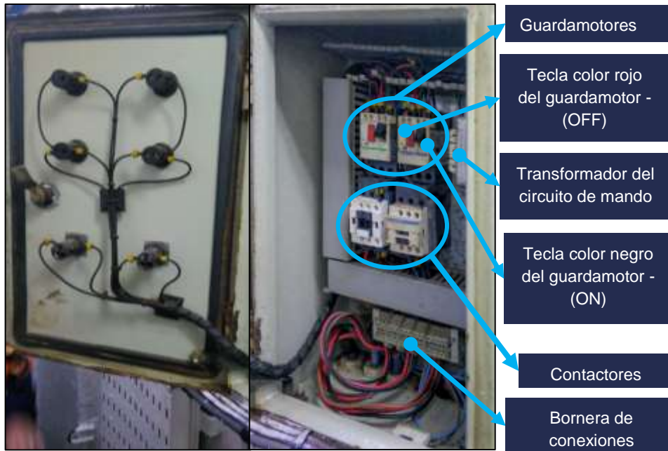
Figura 15. Componentes dentro del tablero eléctrico de las bombas sumergibles de babor y estribor Fuente: Material documental
