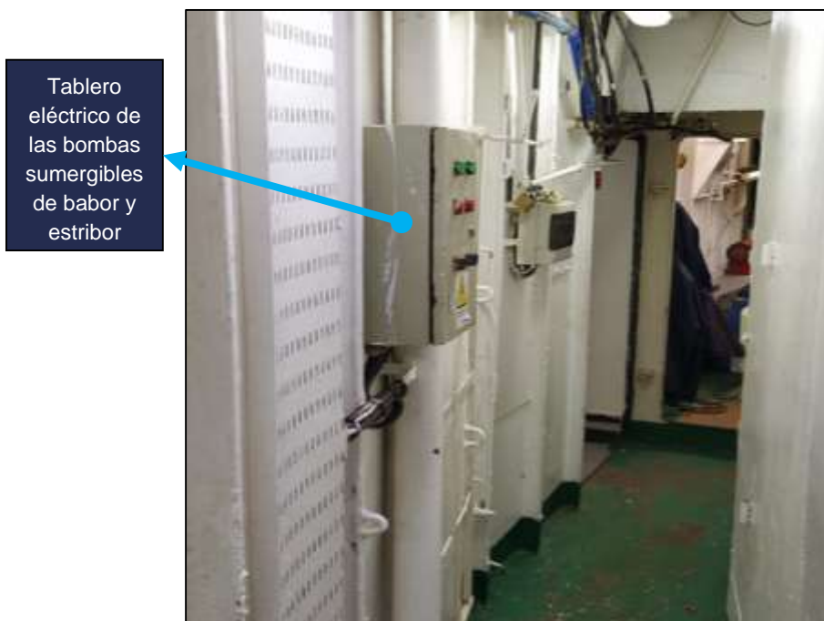
Figura 13. Pasillo interno del B/P Conarpesa I, en donde se encontraba el tablero eléctrico que suministraba energía a las bombas sumergibles de babor y estribor
