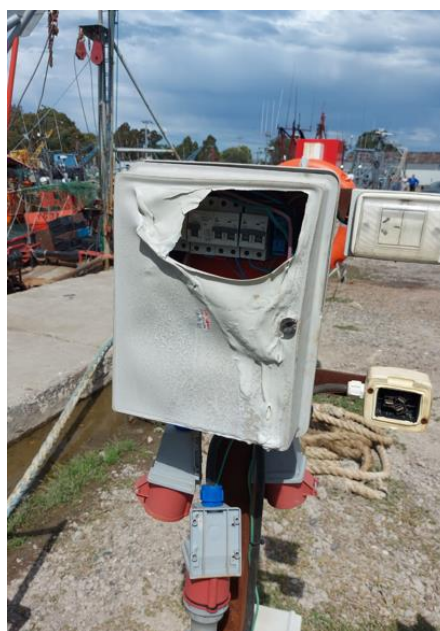
Figura 17. Toma eléctrica a la que el B/P Sumatra estaba conectado el día del incendio. Tapa derretida por efecto del incendio.
