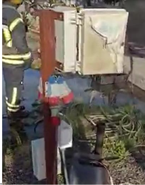
Figura 19. Toma eléctrica de tierra el día del accidente. Se observa derretimiento de la tapa plástica.
