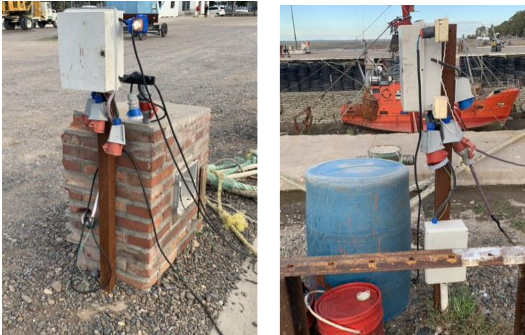
Figura 13. Toma eléctrica de tierra para suministro de energía a buques.
