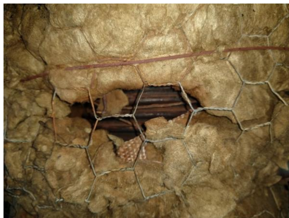
Figura 5. Detalle faltantes de aislación térmica del sistema de exhaustación.
