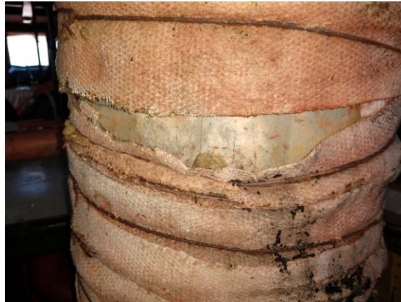
Figura 6. Detalle faltantes de aislación térmica del sistema de exhaustación.
