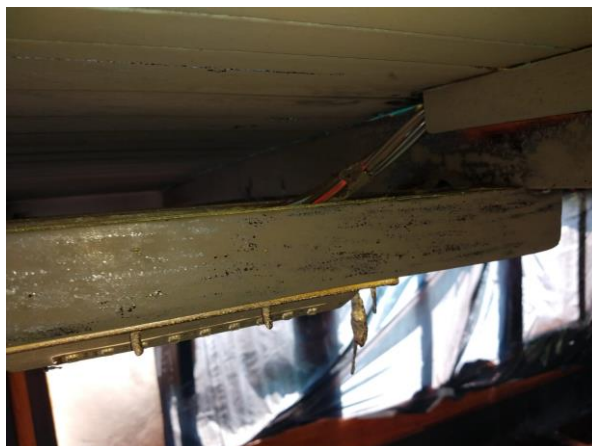
Figura 9. Daños en luminarias, sector medio de la lancha.
