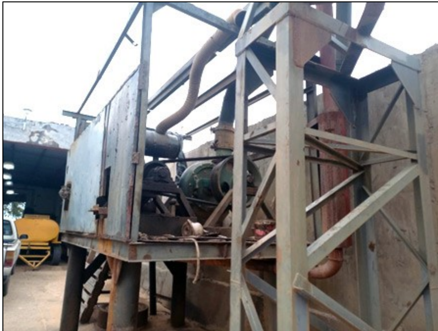
Figura 17. Bomba de rebombeo que se utilizaba desde tierra en la maniobra de descarga Fuente: material documental
