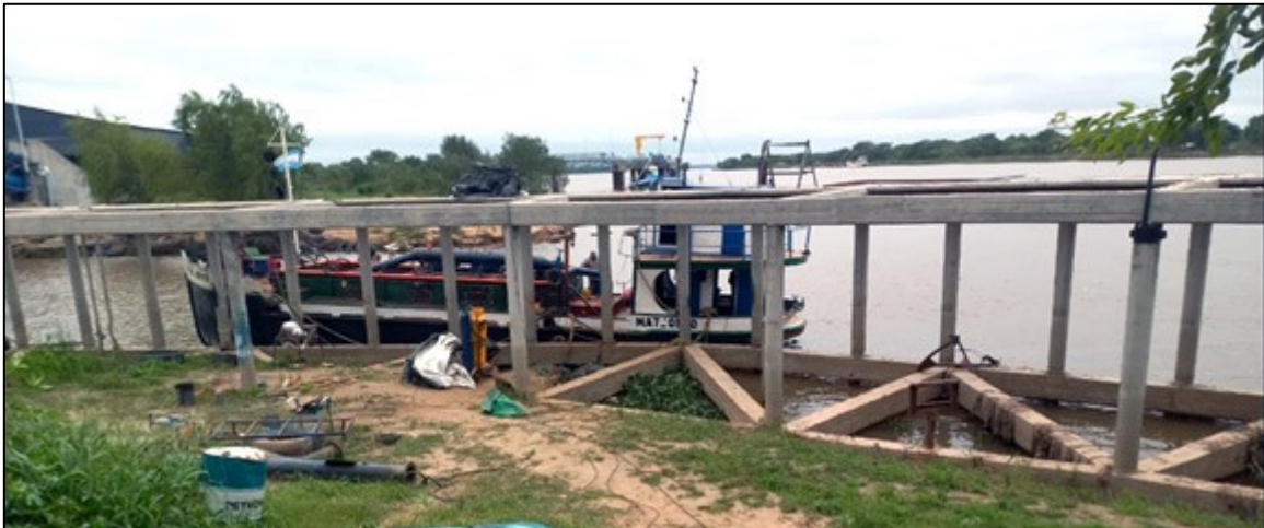
Figura 23. Vista de la estructura de hormigón de la empresa arenera. Se observan amarras pasadas a las columnas de esta estructura
