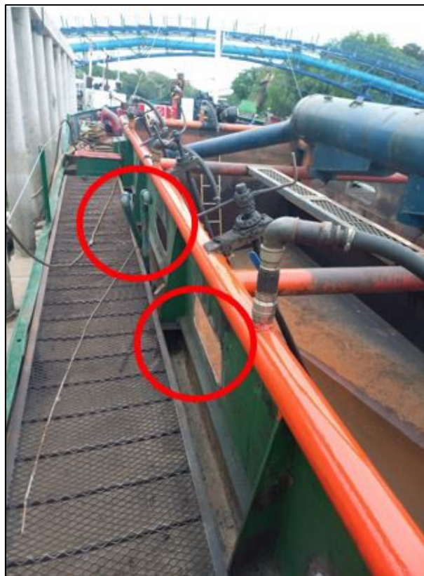
Figura 13. Se observan dos de las cuatro bocas de descarga de la pileta de la banda de babor. Al momento del hundimiento se encontraban obturadas
