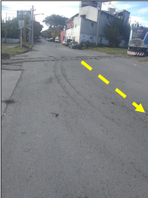
Figura 31. Zona del inicio de la diseminación del fluido
