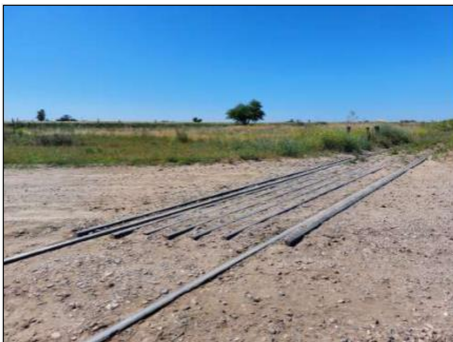
Figura 3. Estado de la vía y ripio de la cama de rieles. Fuente: relevamiento de campo JST, 2021
