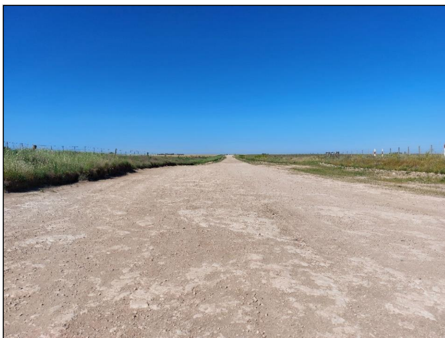
Figura 5. Camino vecinal de tierra, ausencia de señalización pasiva vertical
