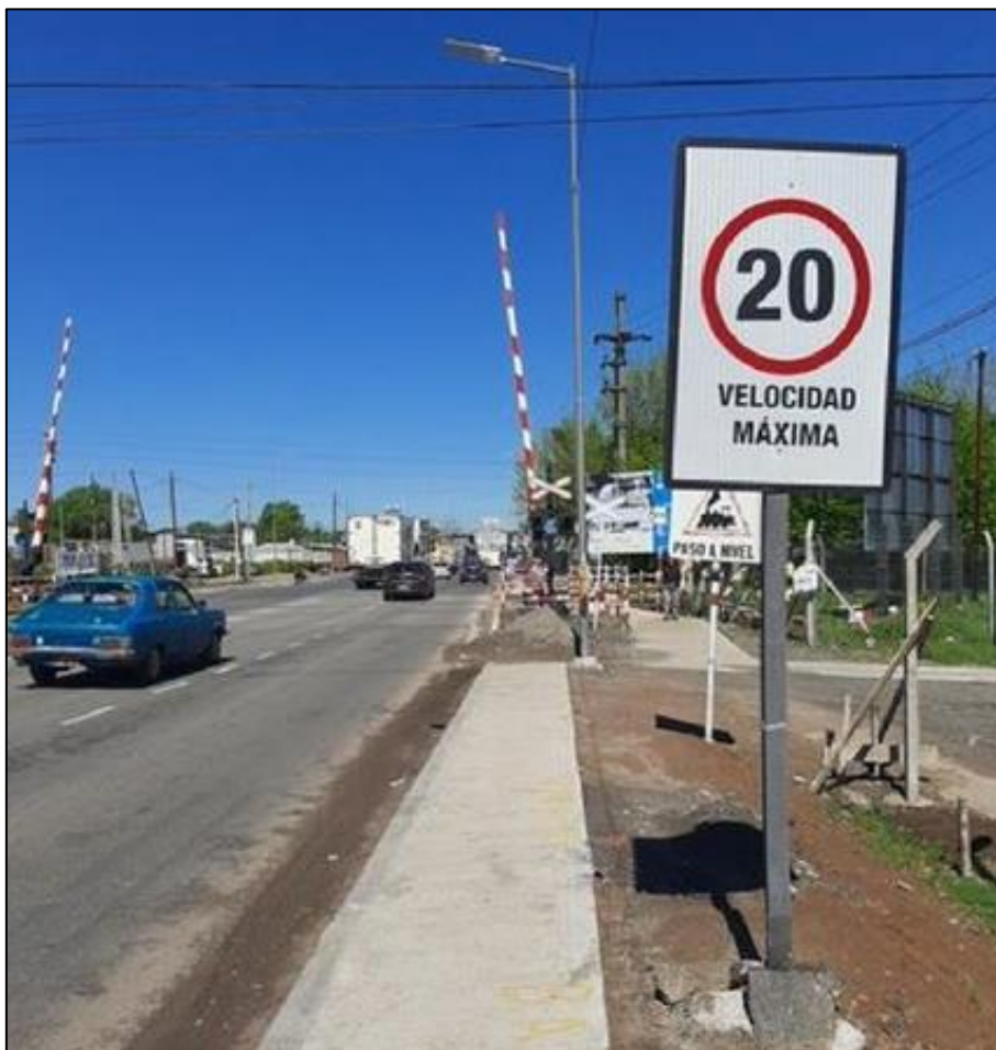
Figura 14. Señalización pasiva vertical (sentido Pilar hacia Escobar). Fuente: JST, 2021
