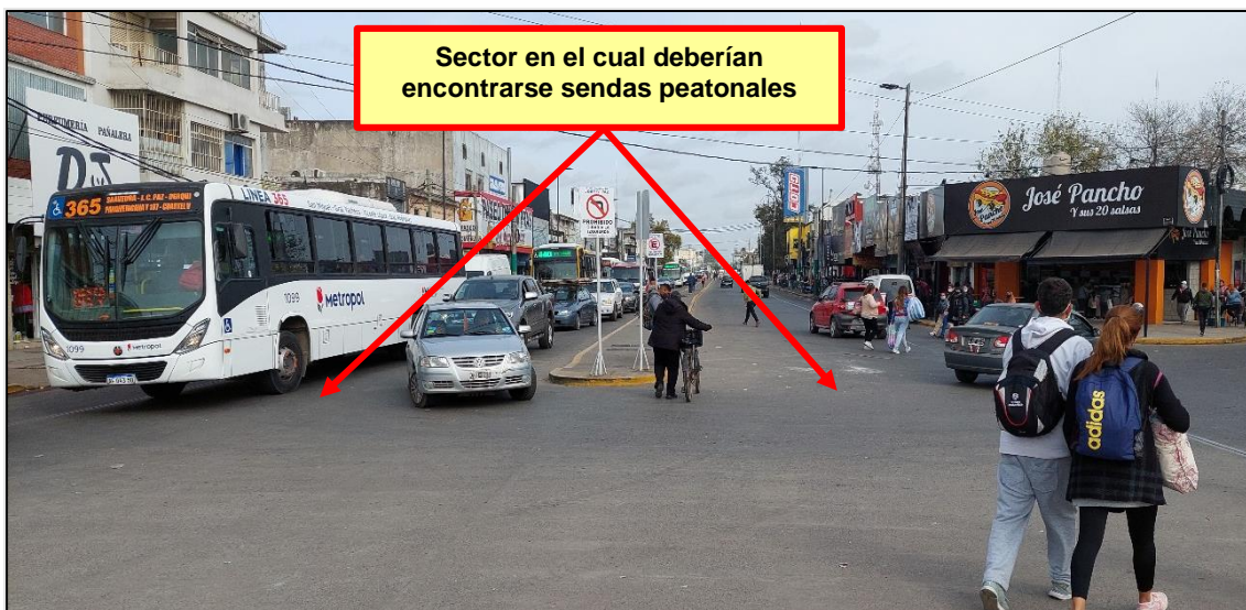
Figura 6. Sector de la RP 24 con sendas peatonales en mal estado. Vista hacia Vucetich
